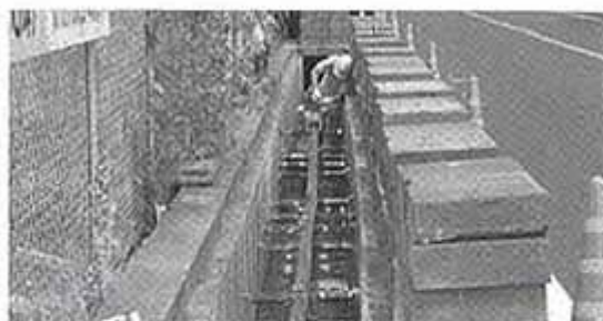
②既設側溝蓋撤去・水平カッター機据付用レールセット
