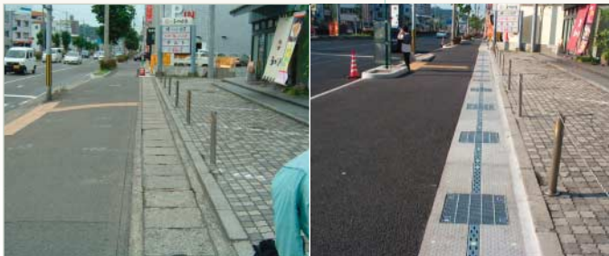
W 2 R工法による改良前(写真左)と改良後(同右)の側溝
